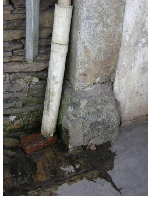
Detalhe – Agressões e falta de manutenção
