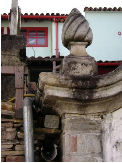
Detalhe – Agressões e falta de manutenção
