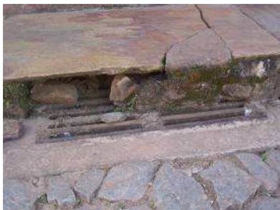
Foto 11.8 – Detalhe de calçada na Rua do Carmo encobrindo o bueiro.
