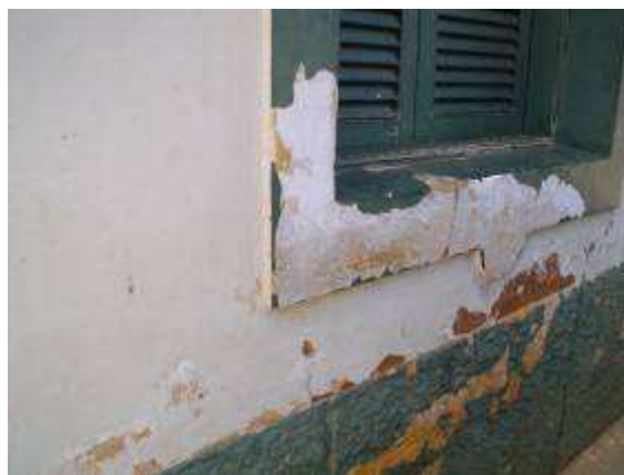
Foto 11.33 – Detalhe de pintura descascando na base do prédio da Escola Municipal na Rua do Carmo.
