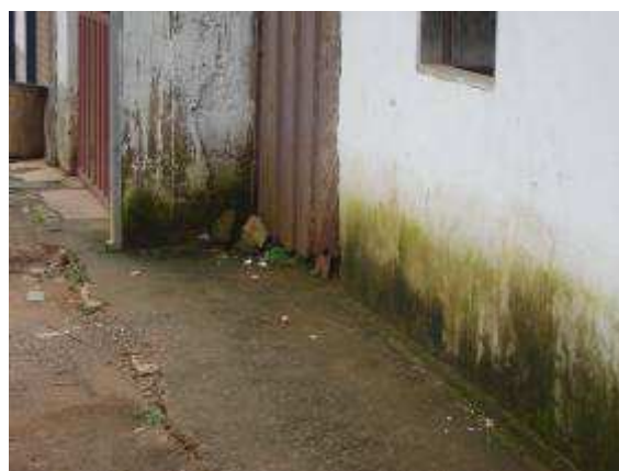
Foto 11.27 – Estreitamento do passeio na Rua do Carmo e manchas de umidade na base da edificação
