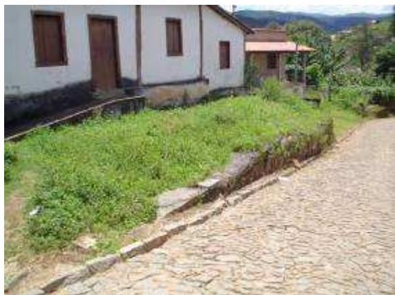
Foto 11.10 – Detalhe de passeio mal conservado na Rua Espírito Santo.
