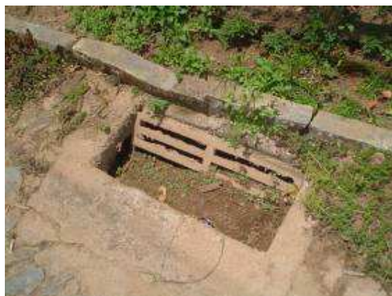
Foto 11.9 – Detalhe do bueiro entupido.
