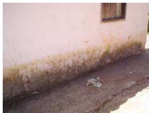
Foto 11.36 – Mancha de umidade na base de uma edificação da Rua do Carmo.
