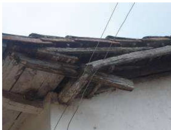
Foto 11.25 – Detalhe de peças do coroamento degradadas por ações de intempéries
