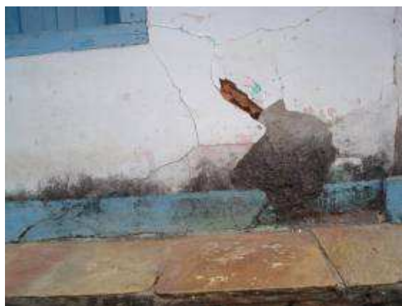
Foto 11.31 – Detalhe de trincas no reboco e manchas de umidade na base da edificação na Rua do Carmo
