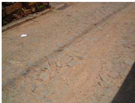
Foto 11.4 – Terra acumulada devido ao empoçamento de água pluviais na Rua do Carmo.
