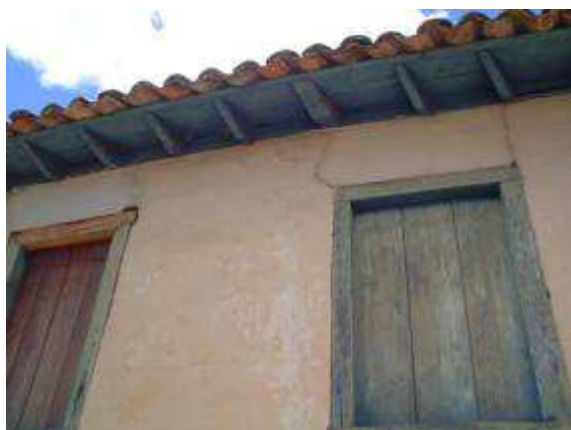
Foto 11.30 – Detalhe de trincas no reboco de edificação na Rua Espírito Santo
