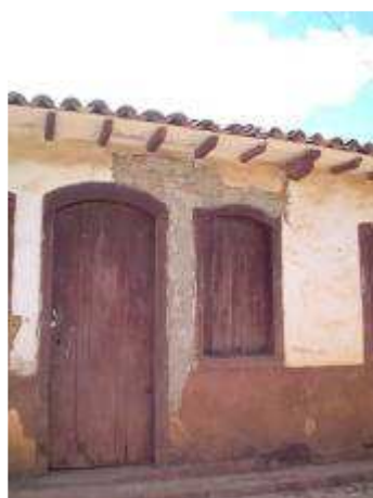
Foto 11.35 – Detalhe de intervenção danosa no reboco com cimento aplicado sobre parede em pau-a-pique em edificação na Rua do Carmo.
