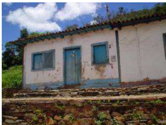
Foto 11.32 – Detalhe de edificação mal conservada na Rua do Carmo.
