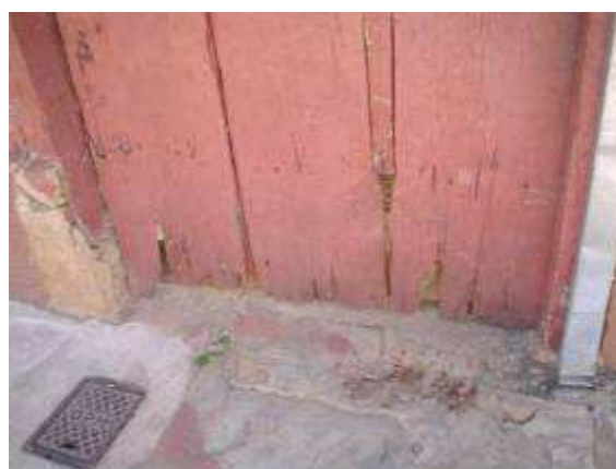
Foto 11.29 – Detalhe de ataque de insetos xilófagos e ação de umidade em edificação na Rua do Carmo.
