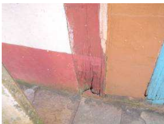
Foto 11.28 – Detalhe de ataque de insetos xilófagos e ação de umidade em edificação na Rua do Carmo
