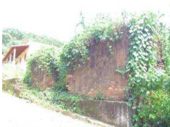
Foto 11.22 – Detalhe de ruína na Rua Espírito Santo.
