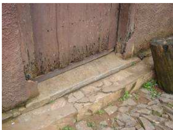
Foto 11.26 – Detalhe de ataque de insetos xilófagos em edificação na Rua do Carmo.
