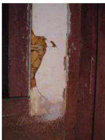
Foto 11.34 – Detalhe do desprendimento do reboco da parede de pau-a-pique
