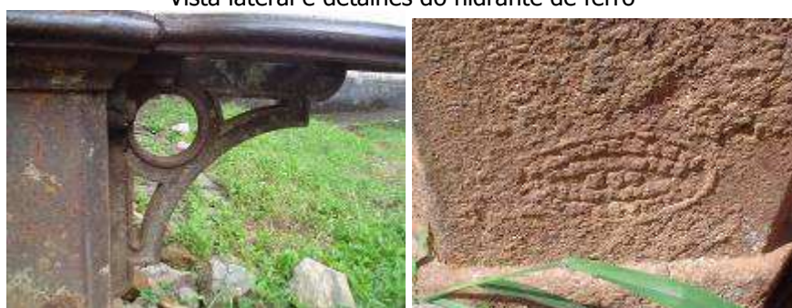
Detalhes do hidrante de ferro
