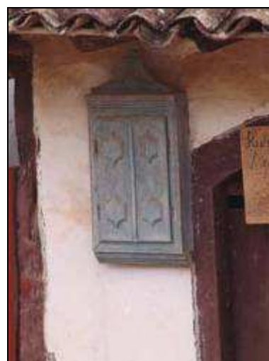
Foto 3.114 – Oratório na fachada da Rua do Carmo, 194. Autor: Raquel Alves Ferreira Janeiro de 2007
